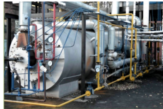
Реактор для производства электропроводного технического углерода
